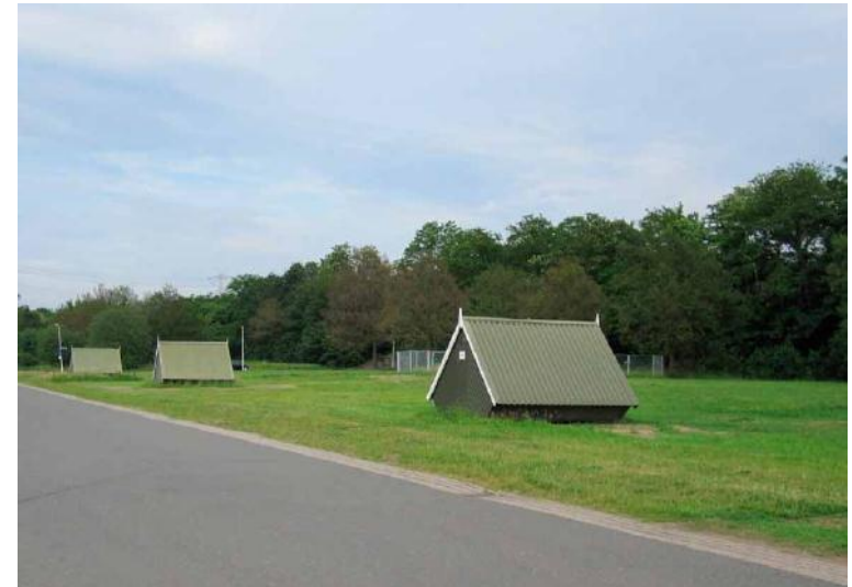
Voorbeeld van een zouthuisjes boven een zoutcaverne (bron: Notitie Reikwijdte & Detailniveau Gasolie-opslag Twente)
